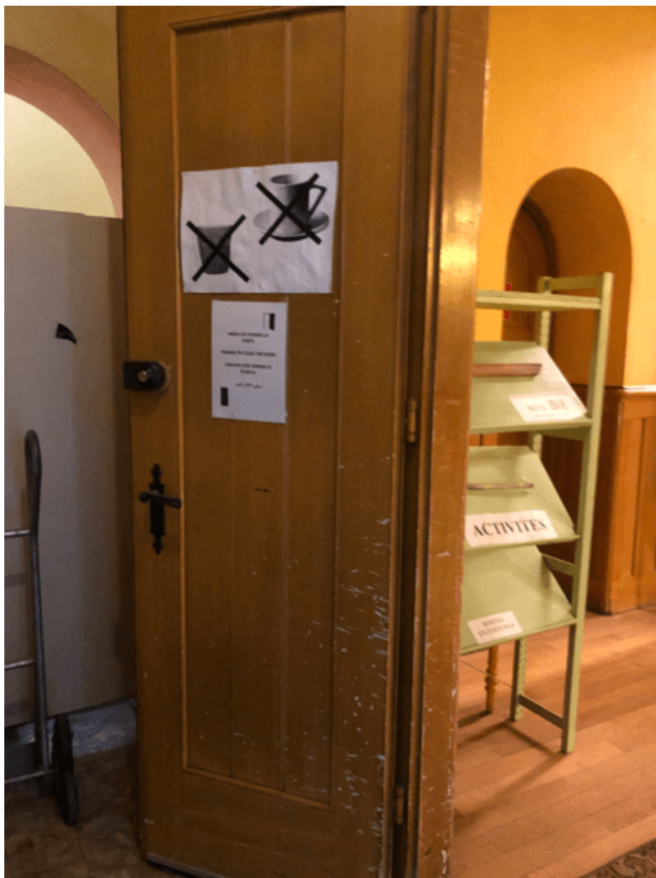
Figure 4 : Photo des auteurs (avril 2021).
