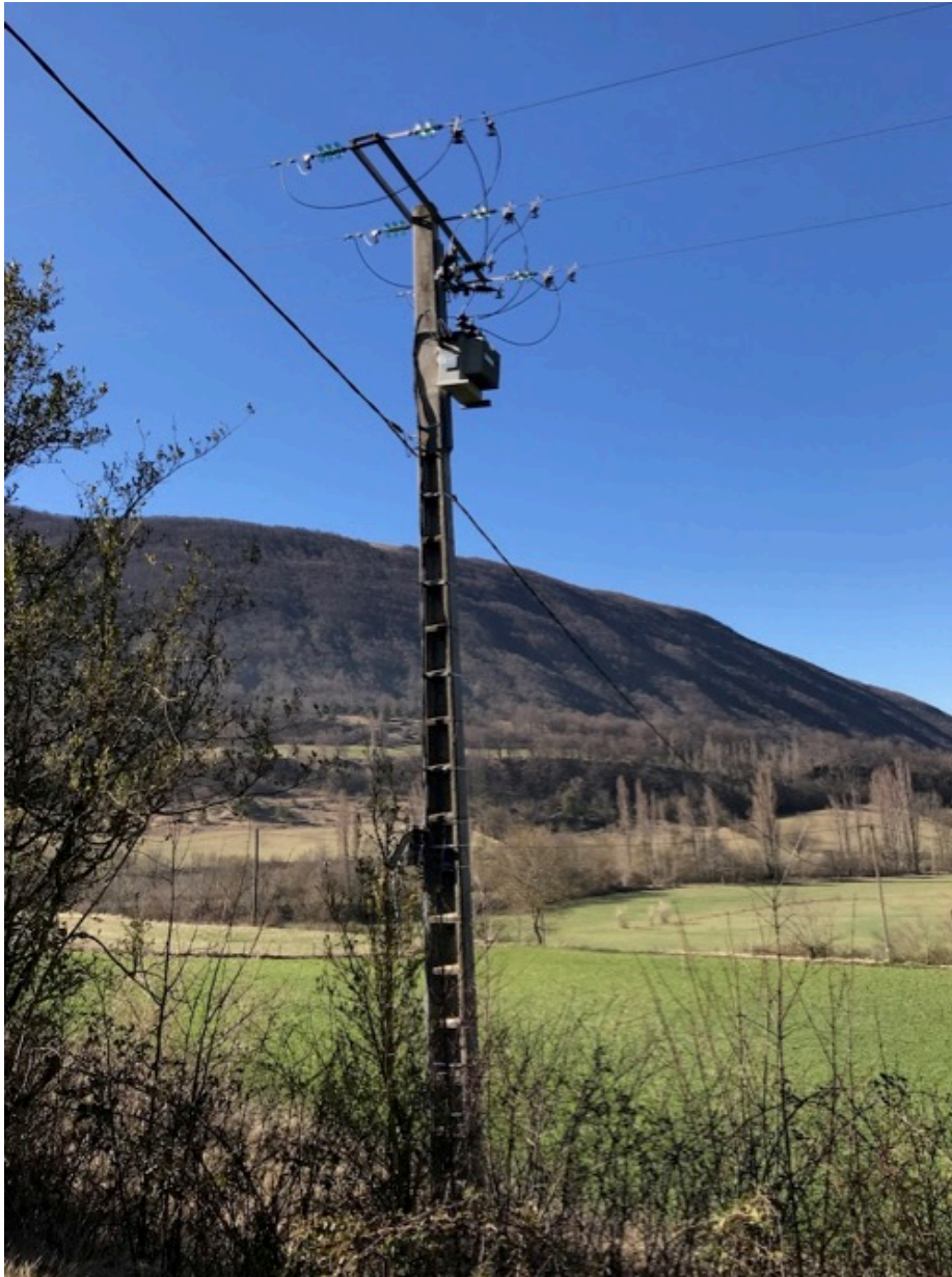
FIG. 5 et 6 Les fils électriques, le poteau électrique : beau, pas beau ?
